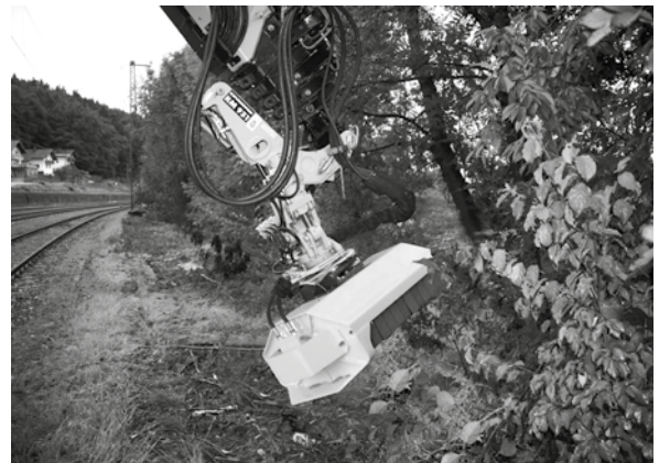
SLA 4 montiert am Manipulator (Krananbau)
